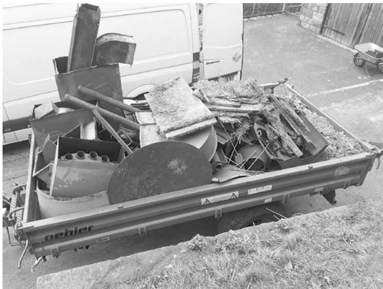
L'ancienne chaudière réduite en un tas de tôles.
